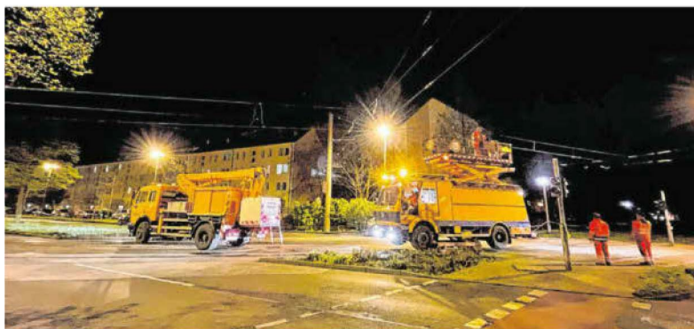
Nachdem ein Lkw am vergangenen Donnerstag eine Oberleitung der Straßenbahn an der Kreuzung von Nordring und Webschulallee abgerissen hatte, musste eine Spezialfirma aus Hannover den Schaden in der folgenden Nacht beheben. Foto: Cottbusverkehr/Fischer
